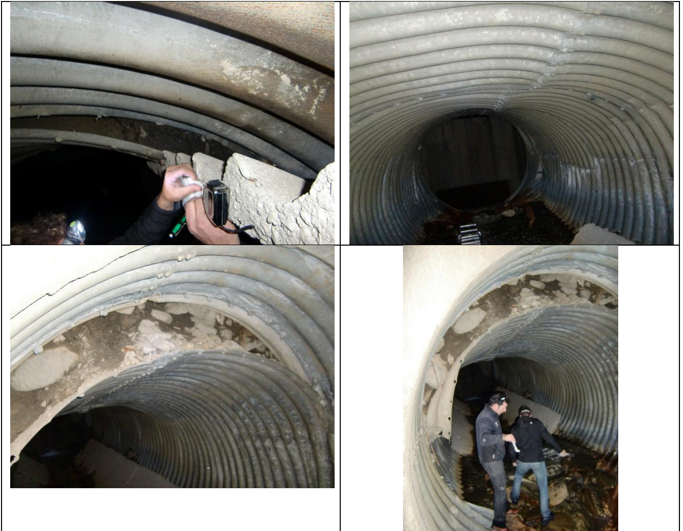
ALTO RIESGO DE HUNDIMIENTO POR MAL ESTADO
