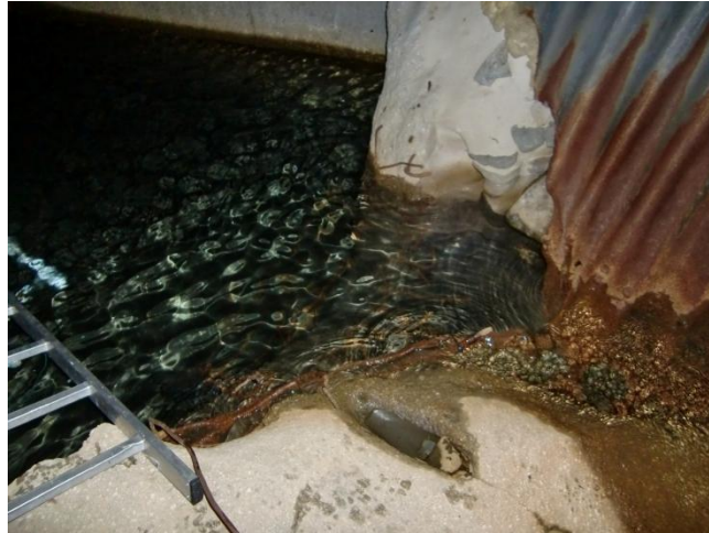
Imagen 3. Deterioros en la unión entre arqueta y tubo.
