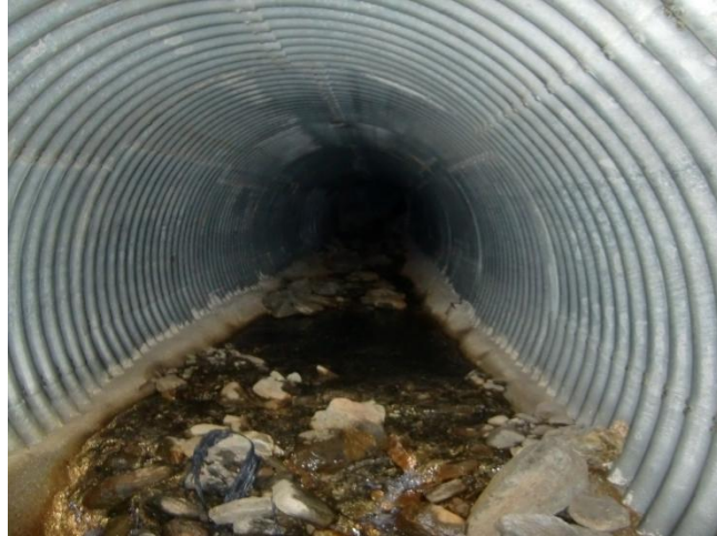
Imagen 4. Material depositado en el interior del tubo.
