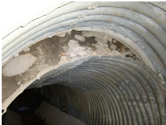
Imagen 1. Hundimiento por presión del terreno.
