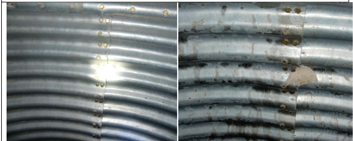
LOS TORNILLOS SE ENCUENTRAN EN BUEN ESTADO NO PRESENTANDO ROTURAS POR CORTANTE
