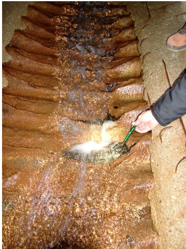
Imagen 2. Base erosionada en el interior del tubo.
