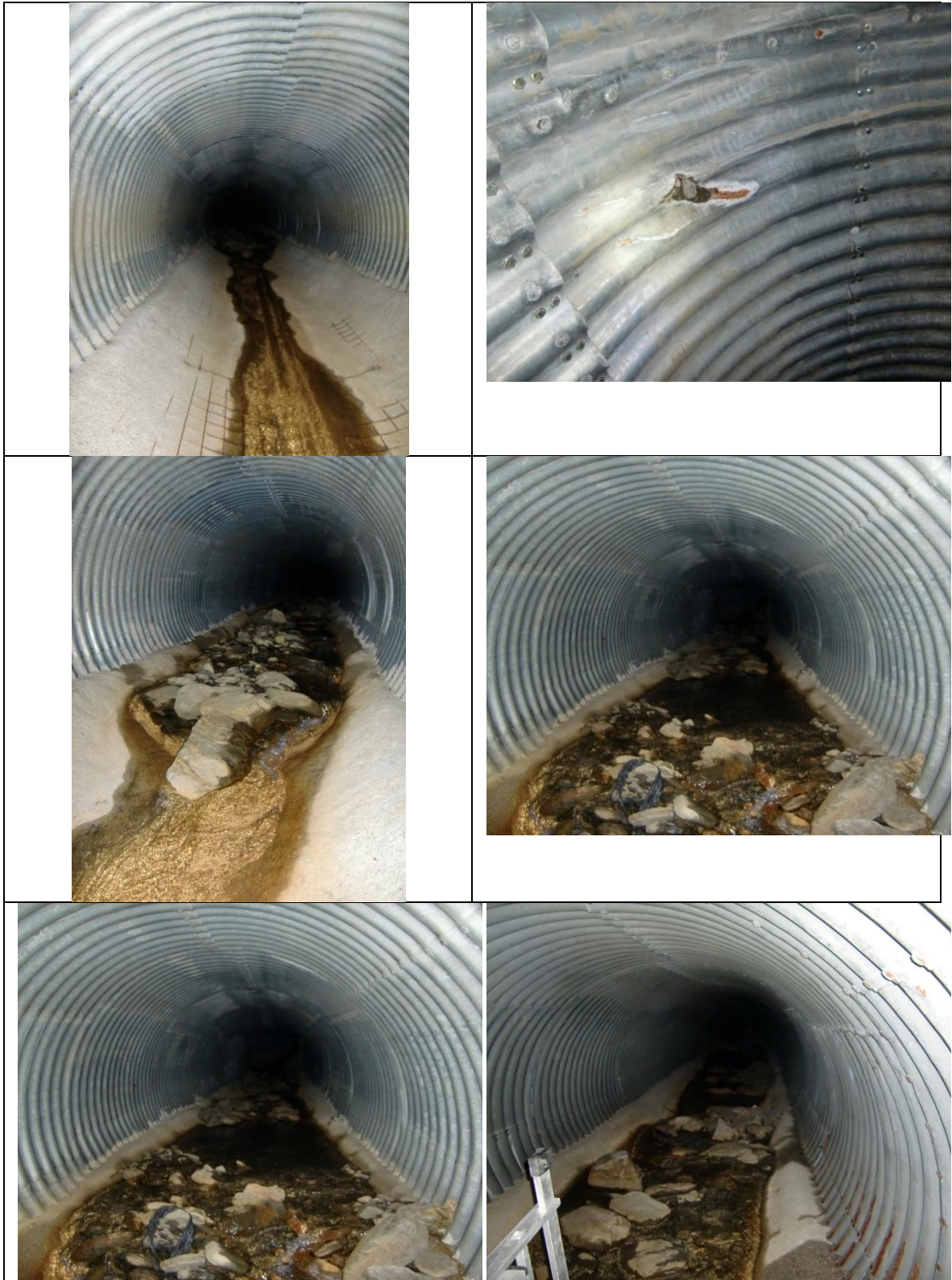
ESTADO DEL TUBO Y ACUMULACIÓN DE SEDIMENTOS POR CAMBIO BRUSCO DE PENDIENTE
