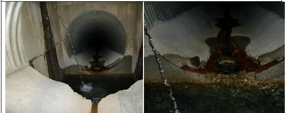
DESGASTE ARQUETA, ZONA A IMPERMEABILIZAR
